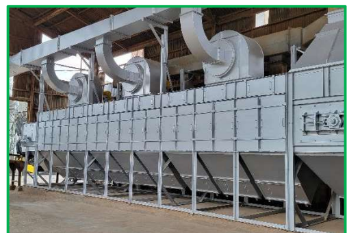
排熱活用の乾燥炉(ものづくり補助金取得設備)
